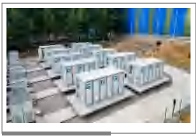
Henan Jinma Energy Smart ESS Project Scale: 34.4MWh
