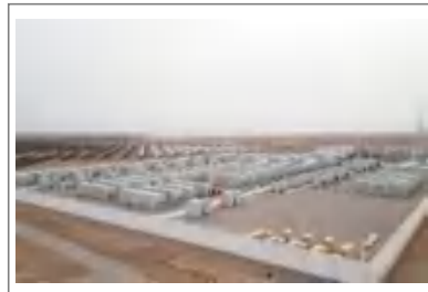
Bachu Agrivoltaic + ESS Project Scale: 140MWh
