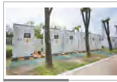
Guangzhou Weili ESS Project Scale: 7.95MWh
