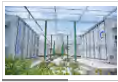
Zhaoqing Zhengxi PV- ESS Project Scale: 8.96MWh
