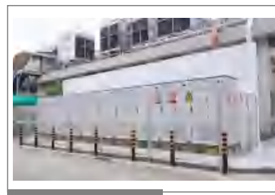
Guangzhou Panasonic ESS Project Scale: 3.01MWh
