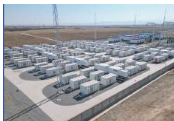
甘肃武威 420MWh 独立储能电站
