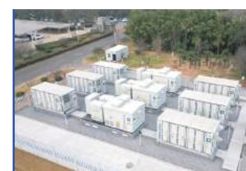
河南中原内配集团 40MWh 项目
