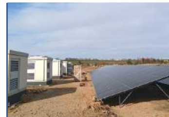
德国 16.77MWh 集装箱储能项目
