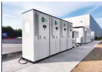
比利时 17.5MWh 分布式储能项目
