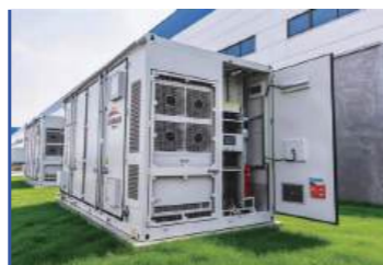
青岛北岸 5.39MWh 钠离子储能项目
