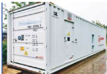
克罗地亚 17MWh 光储互补项目
