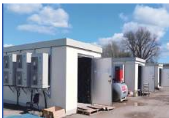
瑞士 3.6MWh 光储一体化项目
