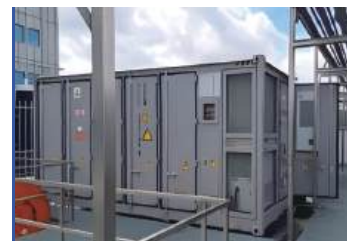
荷兰 9.5MWh 分布式储能项目
