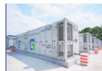
浙江仙鹤新能 44.72MWh 项目
