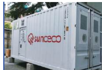
克罗地亚 1MWh 储能项目 (鹏辉最早海外项目, 2018 年并网)
