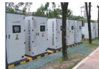
广州维力医疗 7.955MWh 项目
