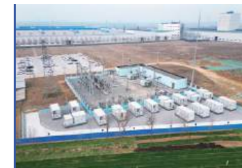
青岛北埠 90MWh 项目
