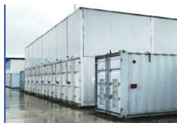
江苏金企造船厂 100MWh 储能电站项目
