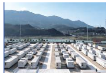
四川中孚 428.48MWh 储能项目
