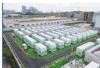
广西南宁 100MWh 储能电站项目
