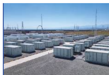
新疆吉木萨尔 150MWh 光储项目
