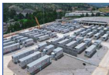
大理祥云县 400MWh 储能电站项目
