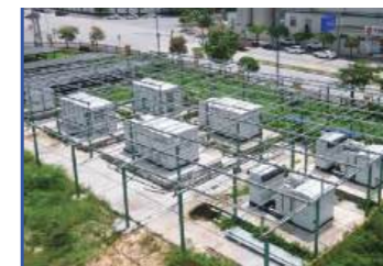
肇庆正光光伏扶贫 8.96MWh 项目
