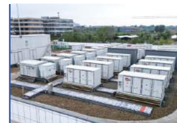
青岛北岸城晖 150MWh 项目
