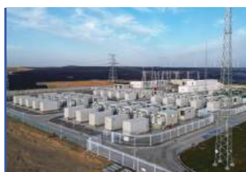
宁夏石嘴山 200MWh 光储项目
