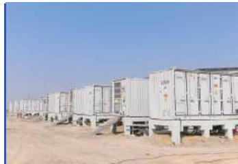
印度阿达尼集团 722MWh 储能项目
