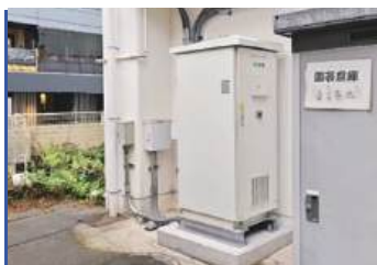
日本横滨学校 15.08MWh 光储项目
