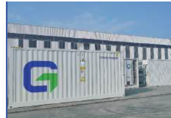
立陶宛 180MWh 储能项目
