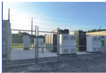
美国弗吉尼亚 150MWh 分布式储能项目
