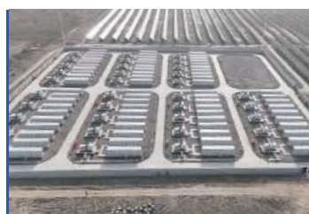
新疆图木舒克 350MWh 光伏储能项目
