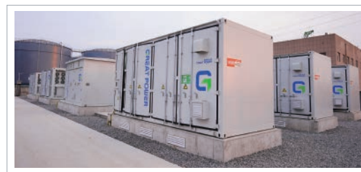
金利金铅 24.08MWh 智慧能源项目
