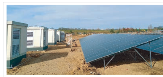
德国 16.77MWh 集装箱储能项目
