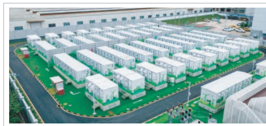
南宁 100MWh 储能电站项目
