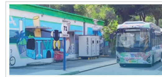
云天励飞-深圳巴士 60MWh 充电站项目
