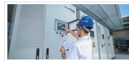
广州新力 2.33MWh 分布式储能项目
