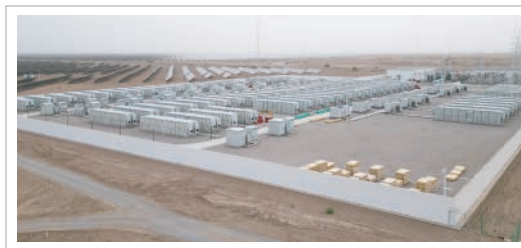
巴楚 140MWh 牧光互补项目
