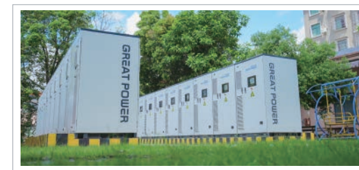
云浮先丰不锈钢制品有限公司 4.3MWh 储能项目
