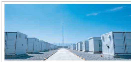
吉木萨尔 150MWh 光储项目
