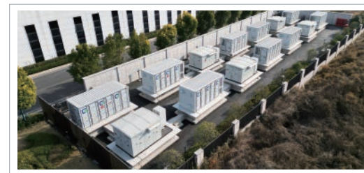
明晟新材料 30.96MWh 智慧能源项目
