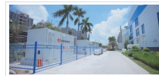
珠海工业园 29.77MWh 用户侧储能项目
