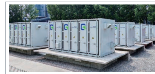
金马能源 34.4MWh 智慧能源项目
