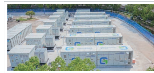
仙鹤新能源 44.72MWh 智慧能源项目
