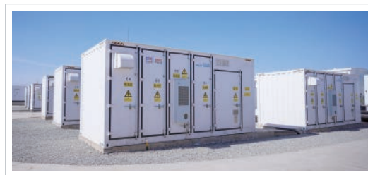
武威 420MWh 独立共享储能项目
