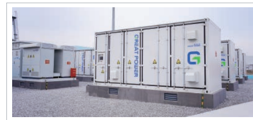
安阳神龙腾达 34.4MWh 智慧能源项目
