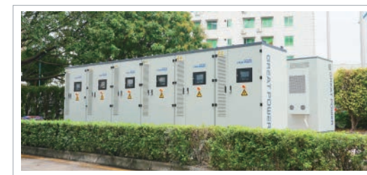
广州工业园 7.33MWh 分布式储能项目
