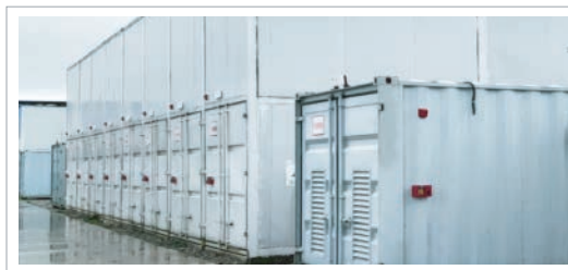
江苏央企某造船厂 100MWh 储能电站项目
