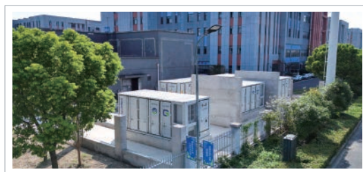
常州湖塘科技园 10.32MWh 智慧能源项目
