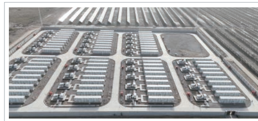
图木舒克 350MWh 光储一体化项目
