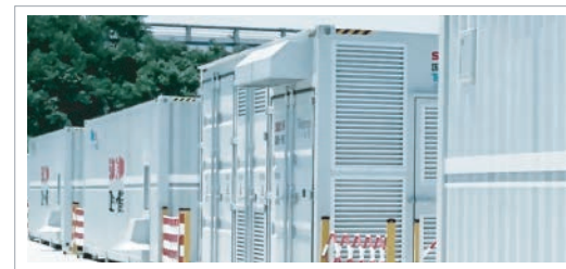
DL工业园 80MWh 储能电站项目
