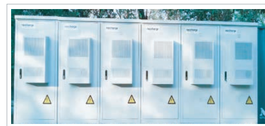
印度 2MWh 离网光储项目
