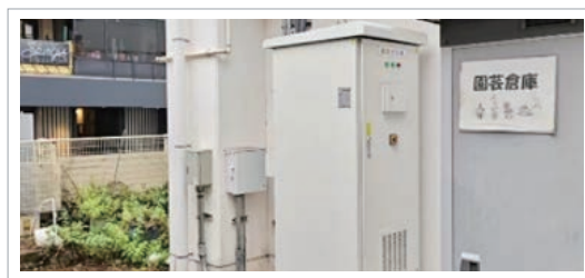
日本横浜学校 15.08MWh 光储项目
