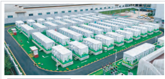
广西南宁 100MWh 储能电站项目
