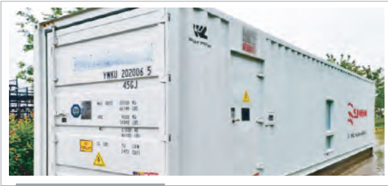
克罗地亚 17MWh 光储互补项目
