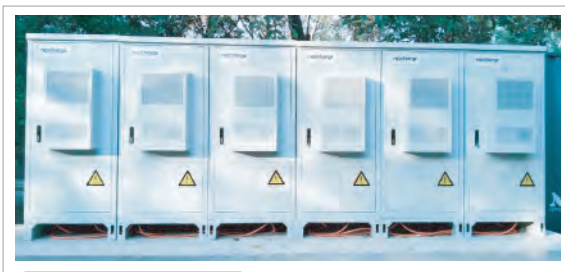
印度 2MWh 离网光储项目
