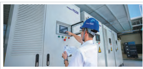
广州新力工业园 2.33MWh 分布式储能项目
