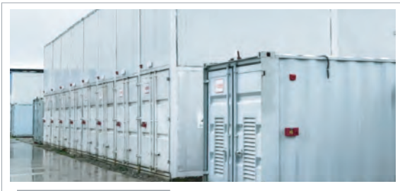
江苏央企造船厂 100MWh 储能电站项目
