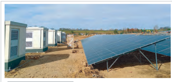
德国 16.77MWh 集装箱储能项目
