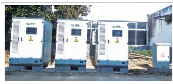
汝南裕信纺织 1.5MWh 分布式储能项目
