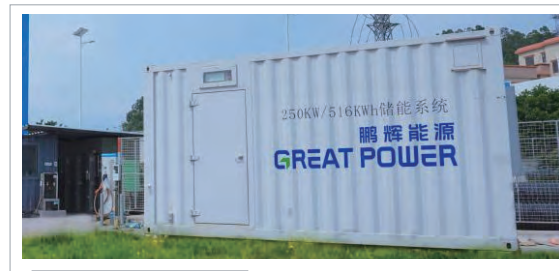
广州云食城智慧产业园1.54MWh分布式储能项目
