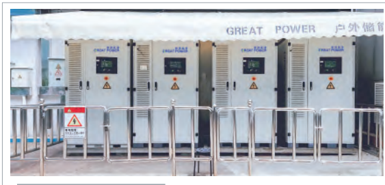
广州工业园 7.33MWh 分布式储能项目
