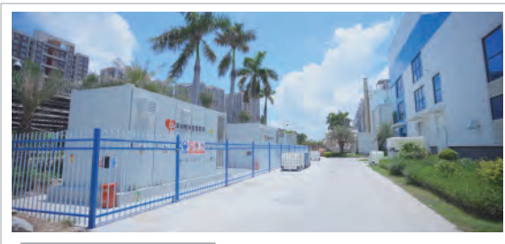
珠海工业园 29.77MWh 项目
