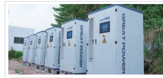
广州冷链园区1.29MWh分布式储能项目
