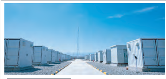
新疆吉木萨尔 150MWh 光储项目
