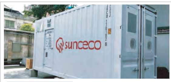
克罗地亚 1MWh 储能项目
