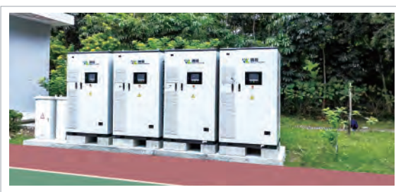
深圳市赢合科技 3.26MWh 分布式储能项目
